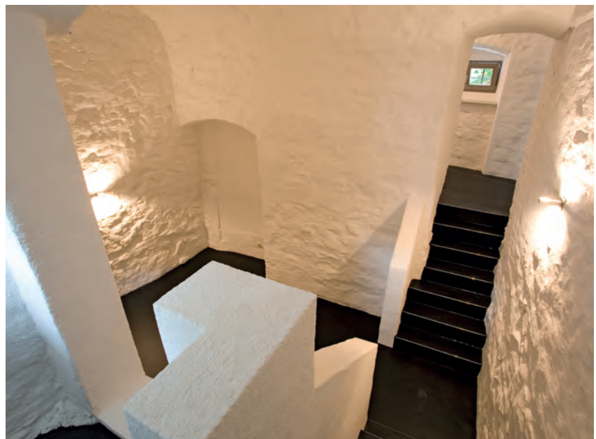
Die vorhandenen Bruchsteinwände wurden mit einer dünnen Kalkschlämme überzogen; ein über alle Geschosse schwarzer Linoleumboden unterstützt die historische Substanz.
